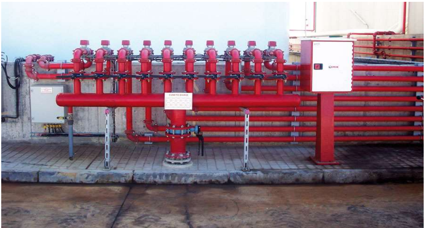
LÍNEAS DE TUBERÍAS (MANCHASOL 1). INITEC ENERGIA
